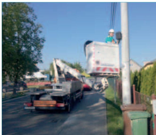
Přenosný radarový sčítač TMS-SA4 (umístění na sčítané místo)
