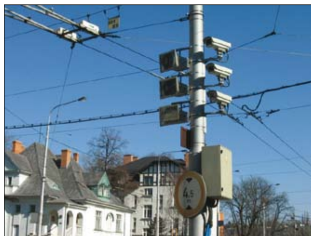
Detail evidenčních kamer
