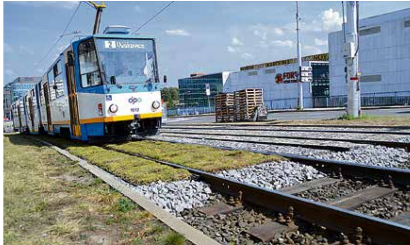
Tramvaj projíždí úsekem se zatím unikátním absorbérem.
