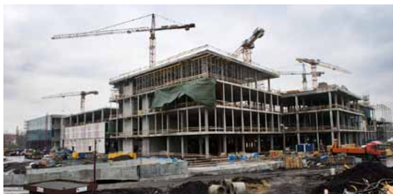
Práce na stavbě obchodně-zábavního centra na Nové Karolině rychle pokračují. Ilustrační foto
