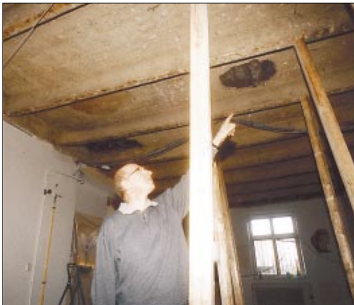
Ředitel Z. Novotný ukazuje odpadlou omítku a trhliny ve zdech domova.
